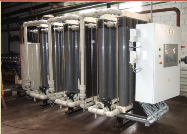
Автоматизированная модульная мембранная установка для водоподготовки (Осиповичская мини-ТЭЦ)
