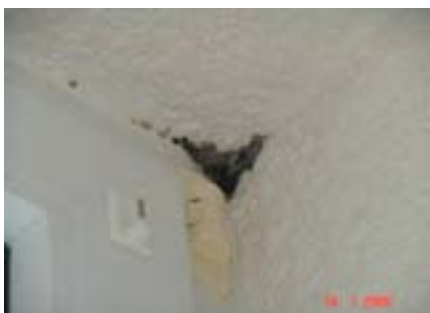
Abb. 13 Detail, Schimmel in einer Außenwanddecke nach Sanierung
