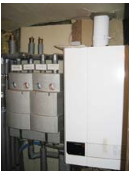
Abb. 39 Moderne, an der Wand hängende Gasbrennwerttherme
