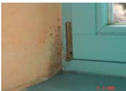
Abb. 14 Detail, Schimmel an einer Fensterlaibung nach Fensteraustausch
