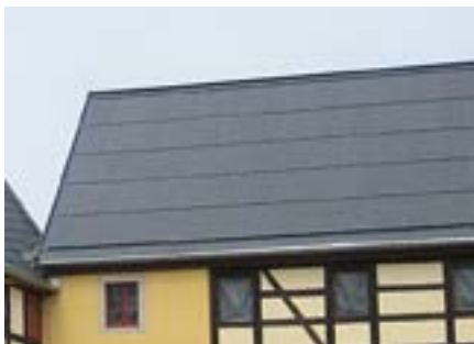
Abb. 10 Nossen, Hauptstraße 33, Detail Photovoltaikanlage
