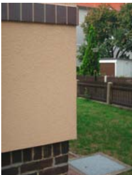
Abb. 38 Fassade, WDVS mit nachgebildetem Simsband aus aufgeklebten Klinkerplatten (schwieriger Kompromiss)
