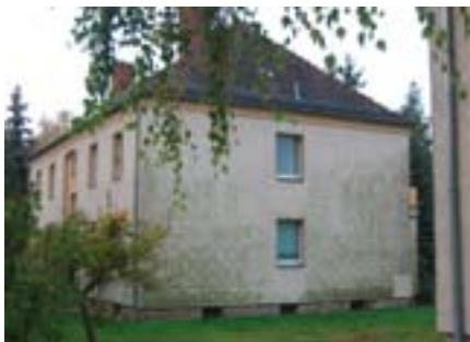
Abb. 12 Fassade nach Sanierung mit Wärmedämmverbundsystem, Algenbildung
